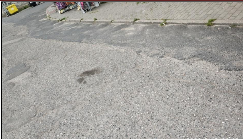
Rys. nr 3 Fragment drogi nr 147026Z, nawierzchnia bitumiczna, krawężniki do wymiany.
