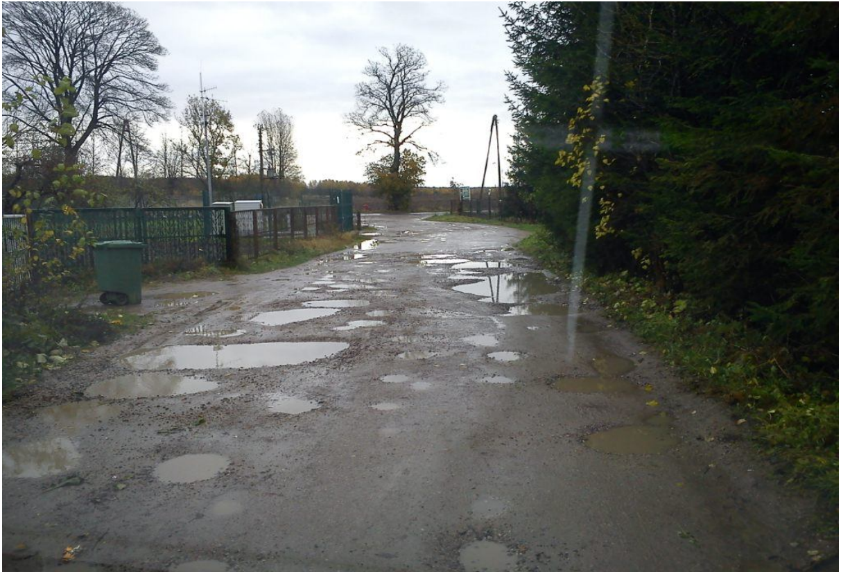
Odcinek drogi nr 146015 Z, nawierzchnia z tłucznia kamiennego od 0+000 do 0+120 km drogi.
