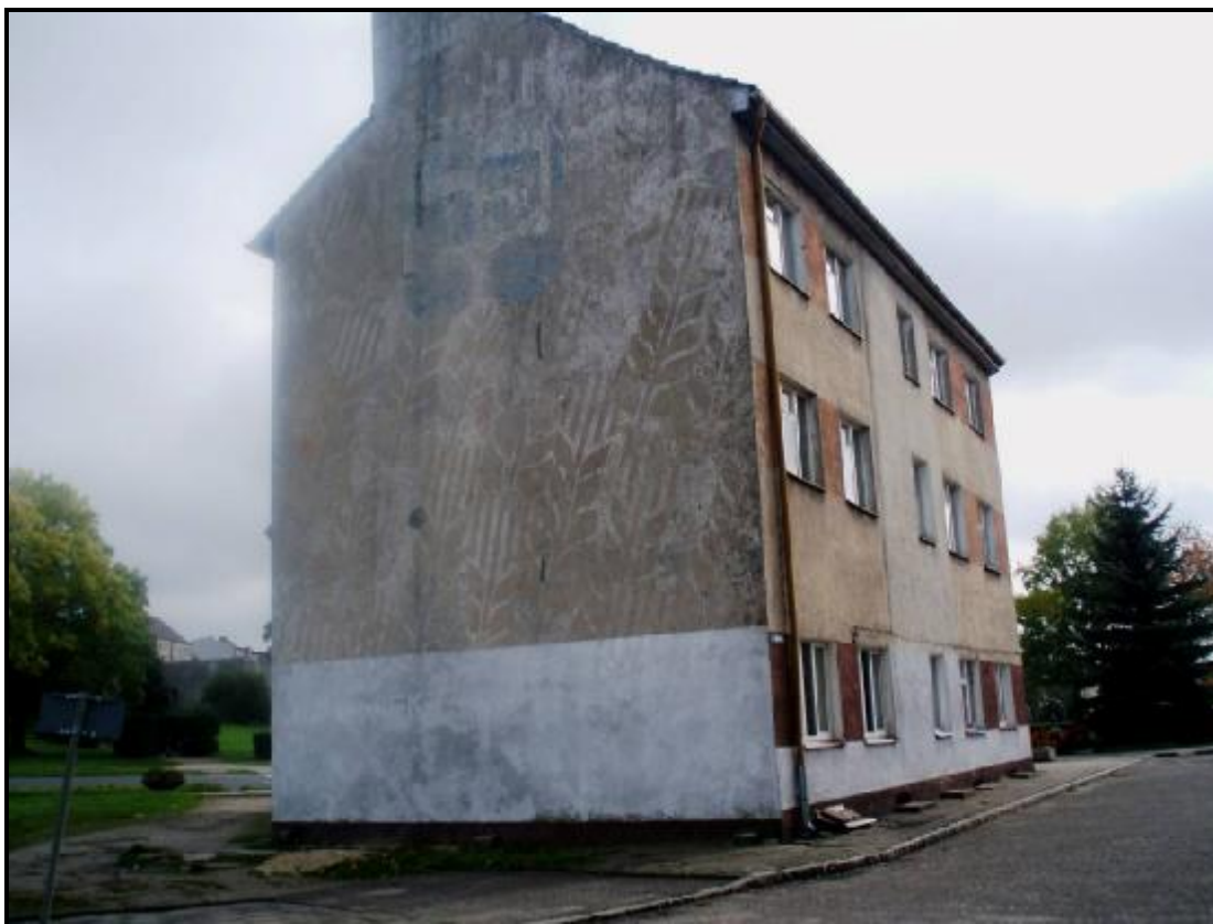
Fot. Stare murale na jednym z budynków w Bobolicach
