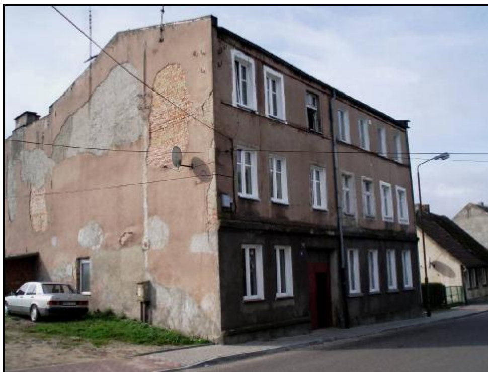
Fot. Przykład złego stanu elewacji w budynku mieszkalnym
