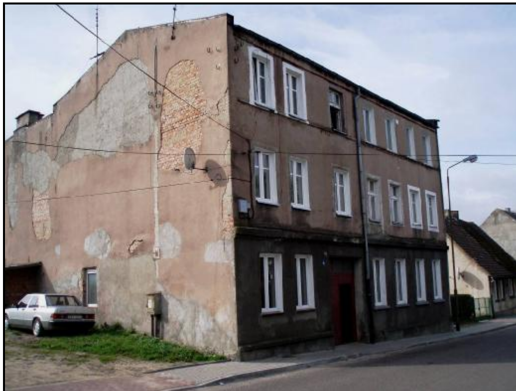
Fot. Przykład złego stanu elewacji w budynku mieszkalnym
