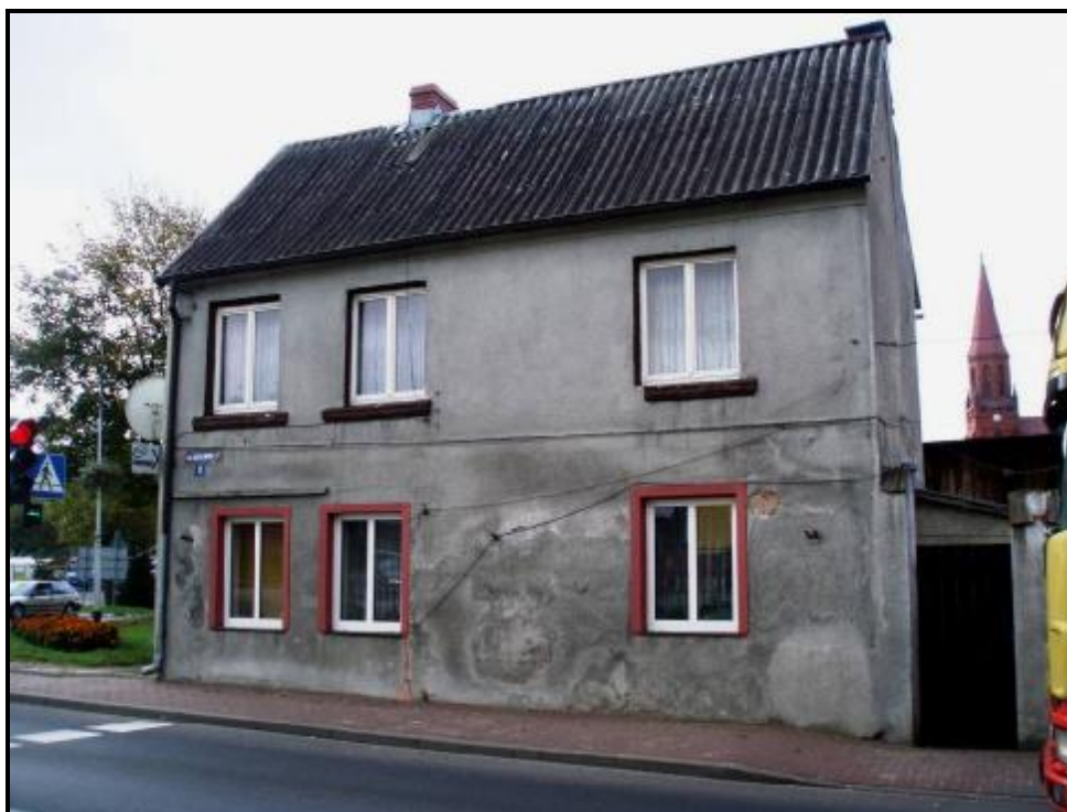
Fot. Budynek mieszkalny pokryty eternitem
